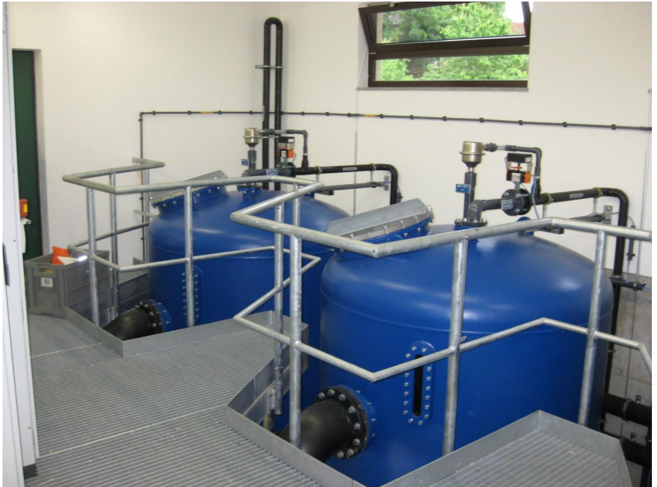
Abbildung 26, Beispiel einer neuen Filteranlage
