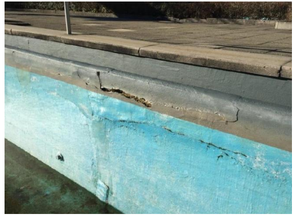
Abbildung 6, Schäden am Beckenrand
