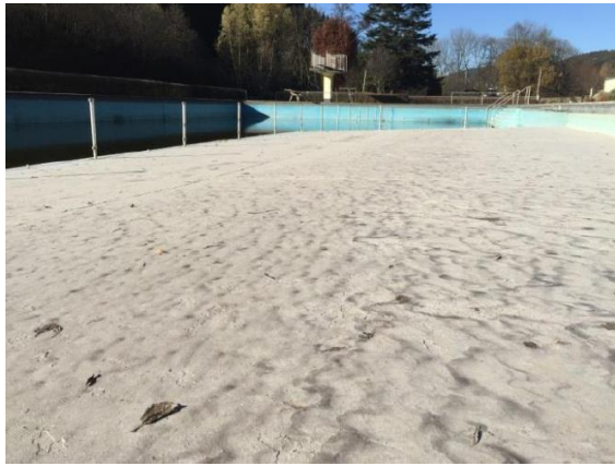
Abbildung 5, Schäden am Beckenboden
