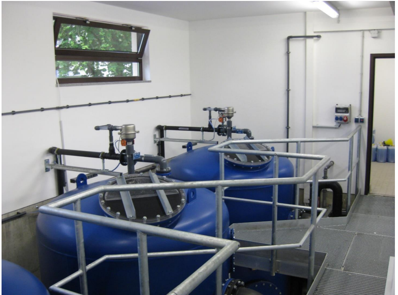
Abbildung 27, Beispiel einer neuen Filteranlage
